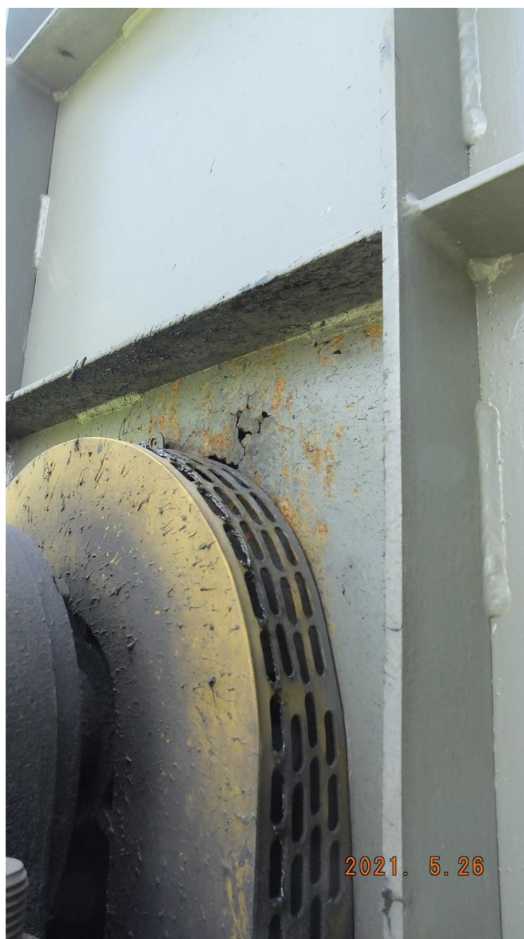
Obudowa wentylatora od strony wału
